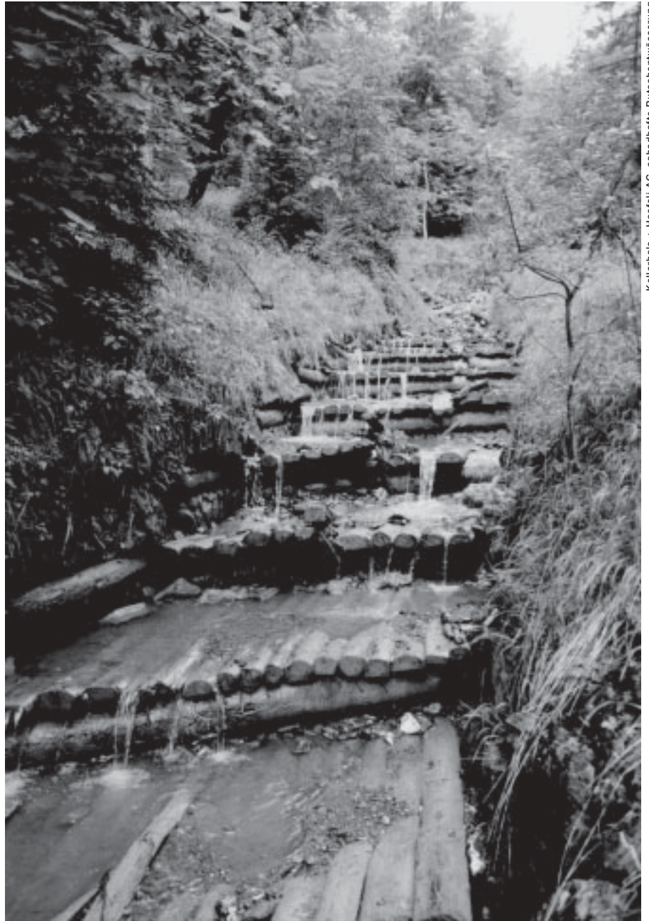
Kellerhals + Haefeli AG, schadhafte Rutschentwässerung
