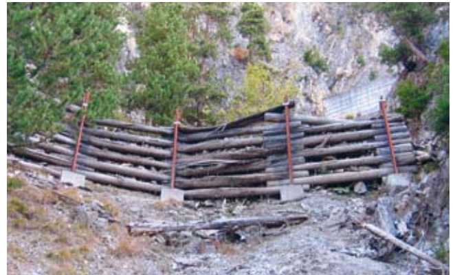
Durch Steinschlag beschädigte und mit Stein- und Erdmaterial hinterfüllte Schutzpalisade.
