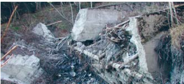
Gebrochene Bachsperre mit ungenügender Schutzwirkung.
