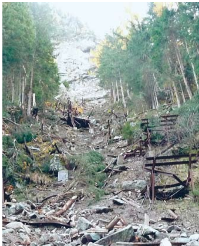
Durch ein Steinschlagereignis völlig zerstörte Verbauung.
