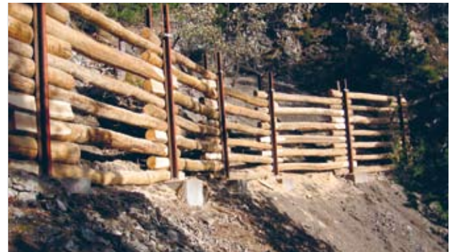
Die im Bild oben dargestellte beschädigte Schutzpalisade ist nach der Instandstellung mittels SIS wieder funktionstauglich.
