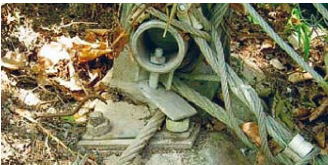
Schäden an Fundamenten einer Steinschlagverbauung: Gerissene Grundplatte der Stütze.
