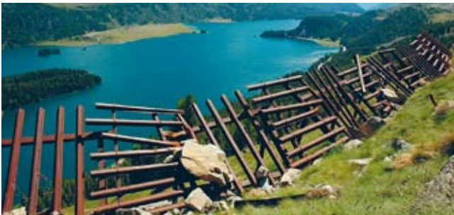
Durch Steinschlag beschädigte Stahlwerke.
