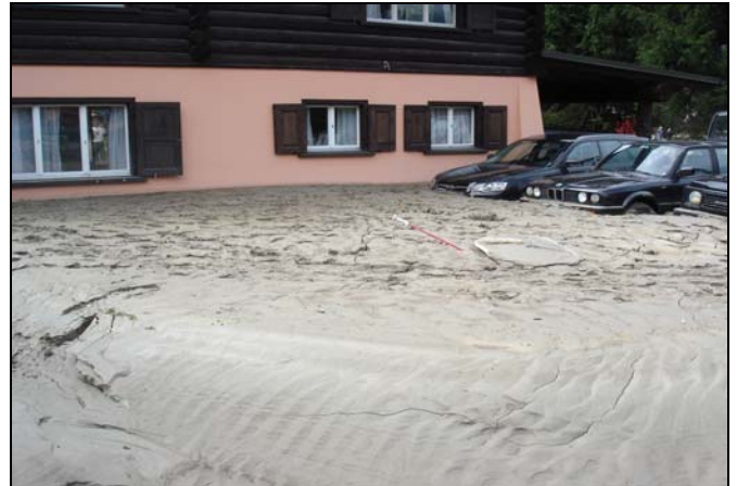
Abb. 8: Schäden an Gebäuden und Fahrzeugen durch Wasser und Feinmaterial (Bild: tur gmbh)
